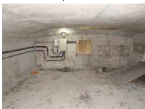
Sistema de parte elétrica
