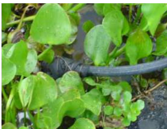
Mangueira Hidráulica Furada.
